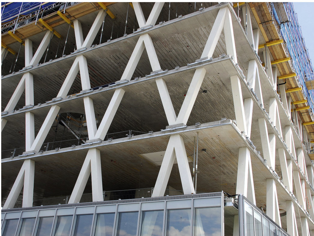
Premiere in der Schweiz für Sorp 10 ist die durchdachte Raumakustik des Roche-Hochhauses in Rotkreuz, wo es in der akustischen Gestaltung in den Decken als integrierender Bestandteil fungiert. Foto Curt Mayer
