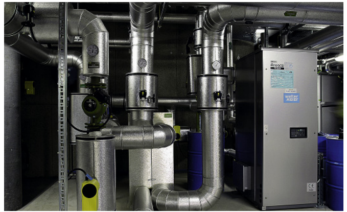
Wärmeüberschüsse aus der Solarthermie-Anlage werden über eine Absorptionskältemaschine in Kälte umgewandelt.
