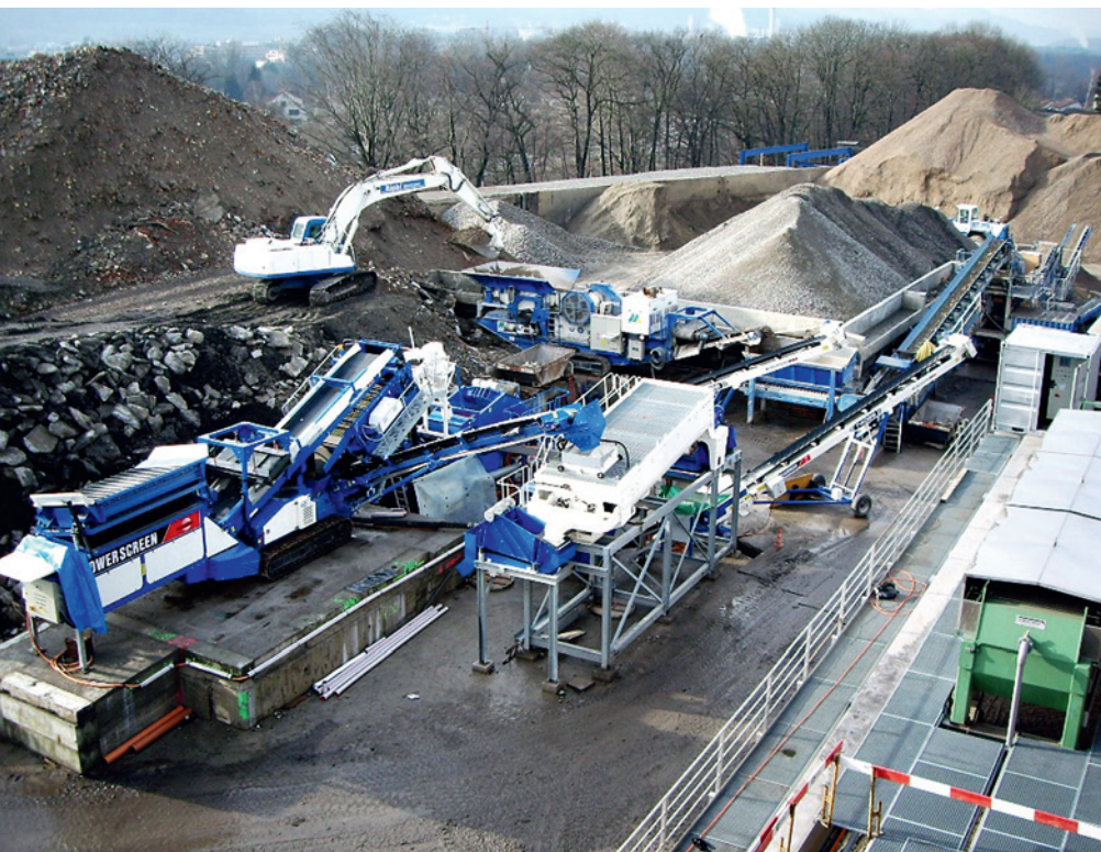
Die Richi AG setzt eine Mischabbruchwaschanlage ein, in welcher das Material nassmechanisch gereinigt und, analog einem Kieswerk, nach Grösse getrennt wird.
