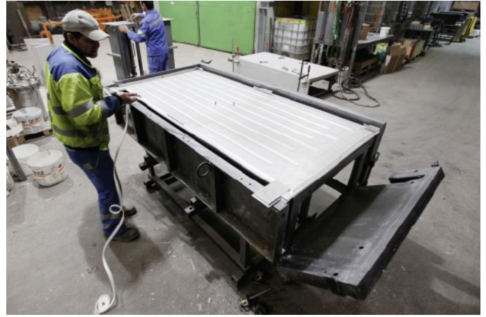
Der Wärmetauscher liegt in der Schalung und wird sorgfältig für das Eingiessen vorbereitet.
