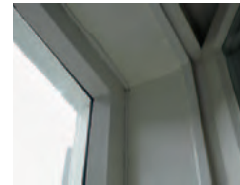
In dieser Situation wurde das Vorfenster bereits mit einer zusätzlichen Dichtung am Blendrahmen versehen.
